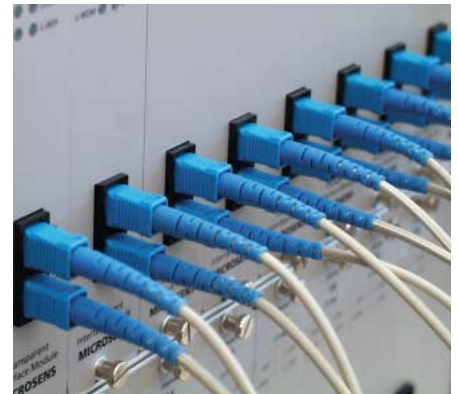
Anschlussleiste für Glasfaserverbindungen
