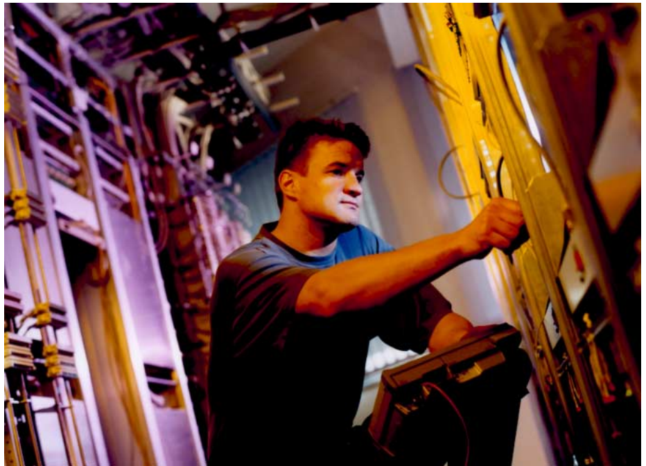
Hier laufen alle Glasfaserkabel der Hansenet zusammen. Ein Anzapfen der Leitungen für Fremde ist an dieser Stelle allerdings nicht möglich.
