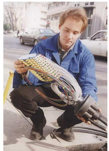
Kabelmuffe in einem Stadtnetz der Colt Telecom. Hier laufen sämtliche Glasfaserkabel zusammen. Quelle: Colt Telecom
